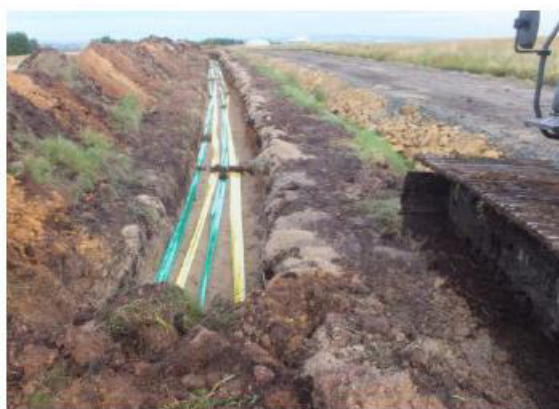
Fotografia 2.16 – Exemplo de uma vala de cabos elétricos
